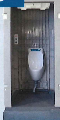
BSK仮設 トイレ
